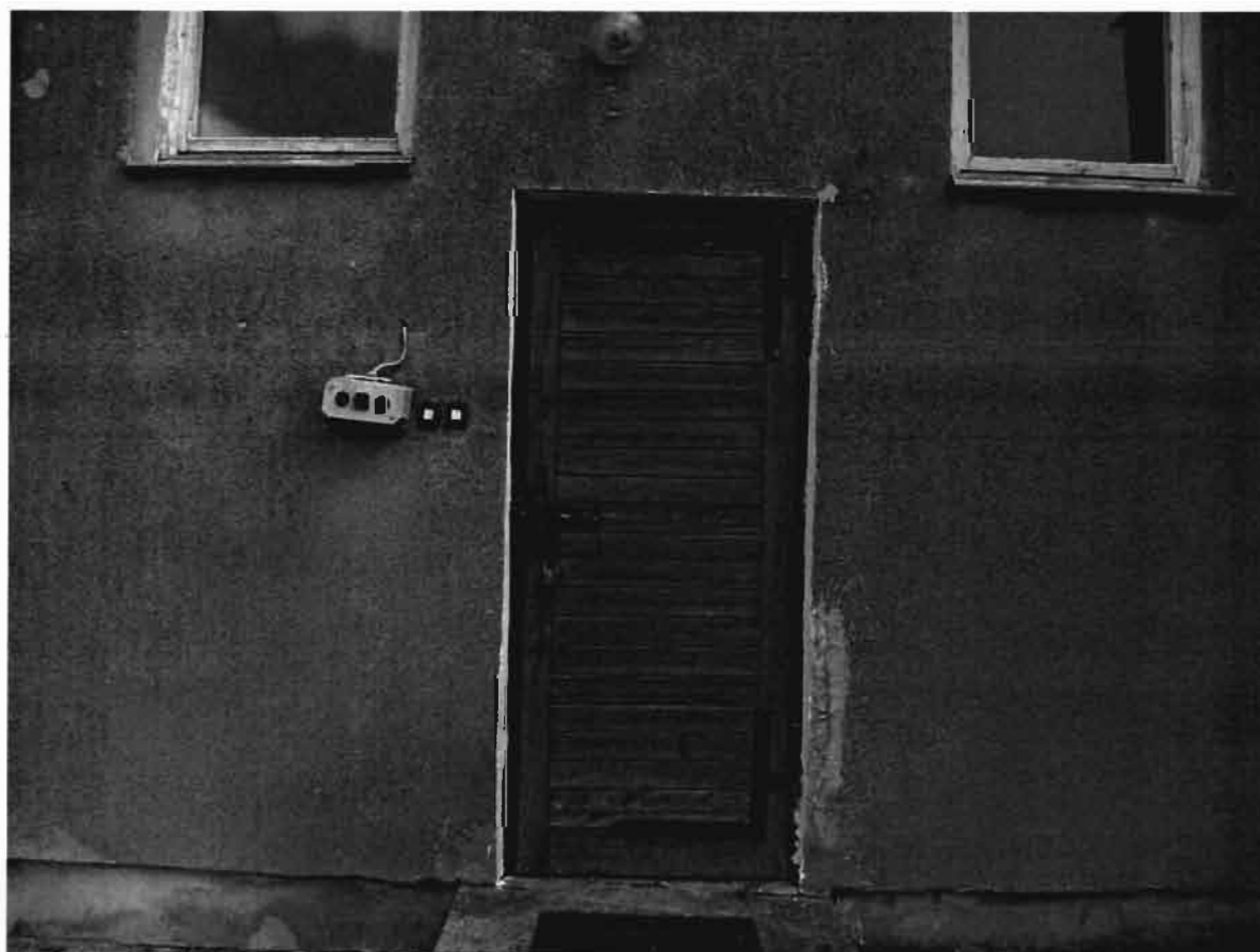
Zdjęcia Z-13 . Drzwi do pom. chlorowni, drewniane, spągowe, nie spełniają warunków aktualnej normy budowlanej. Wymagają wymiany na drzwi o zwiększonej odporności ogniowej, częściowo metalowe.
