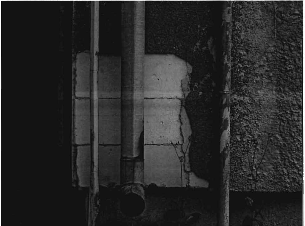
Zdjęcie Z-1. Izolacja pozioma ścian fundamentowych. Ubytki tynku na ścianach nadziemia. Brak opaski wokół budynku.
