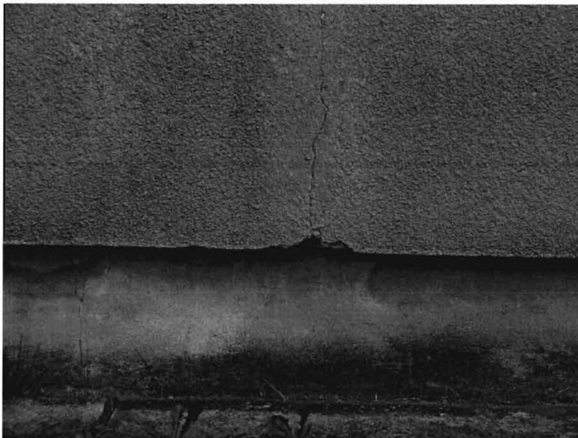
Zdjęcie Z-3 . Rysy na połączeniach elementów „wielki blok” w ścianach zewnętrznych. Widoczne doraźne naprawy w warstwie tynku. Brak okładziny wodoodpornej na cokole budynku.
