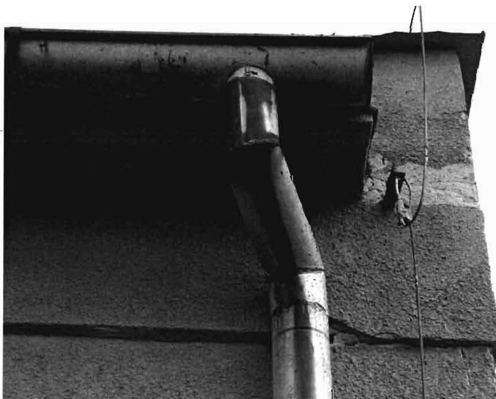
Zdjęcie Z-4 . Brak dylatacji brzegowej gładzi betonowej na stropodachu. Murki ogniowe „ścięte” w poziomie stropu kanałowego.
