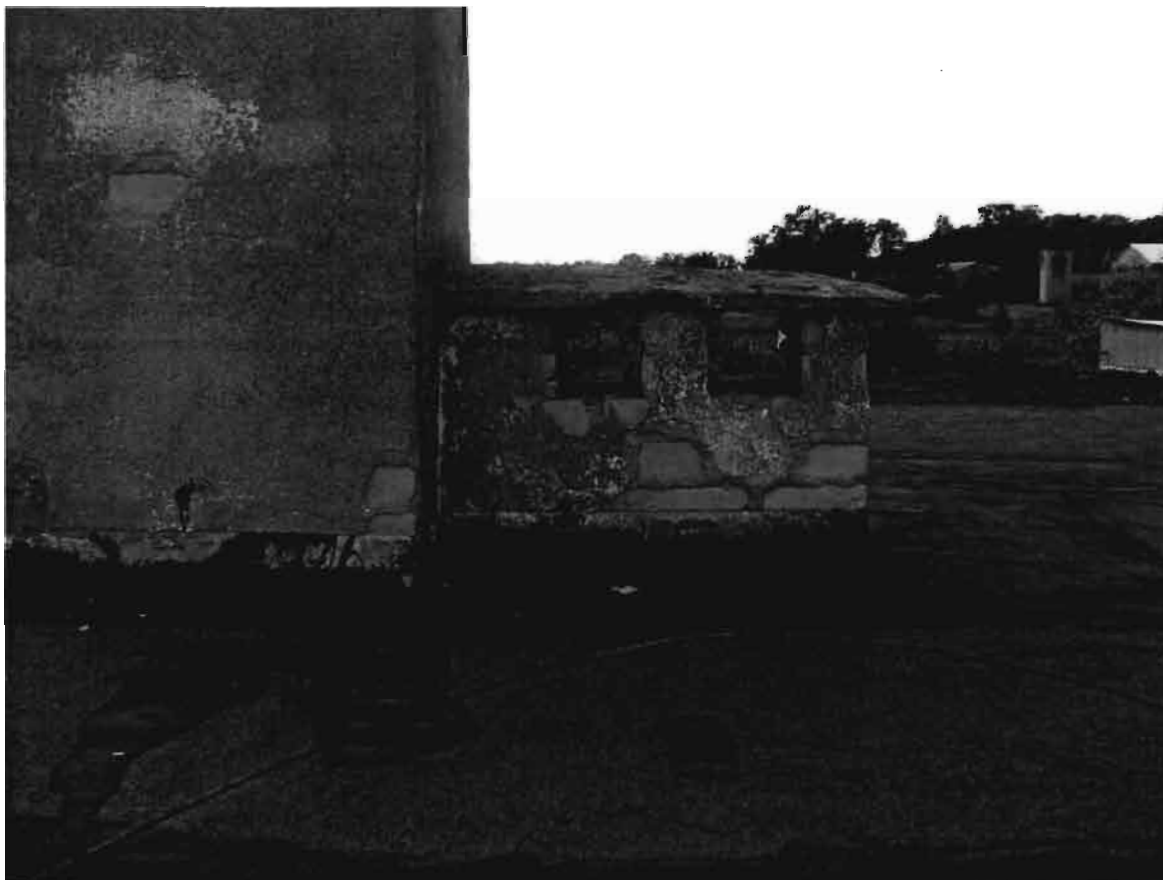
Zdjęcie Z-8. Komin wentylacyjny Nr 2, do przemurowania
