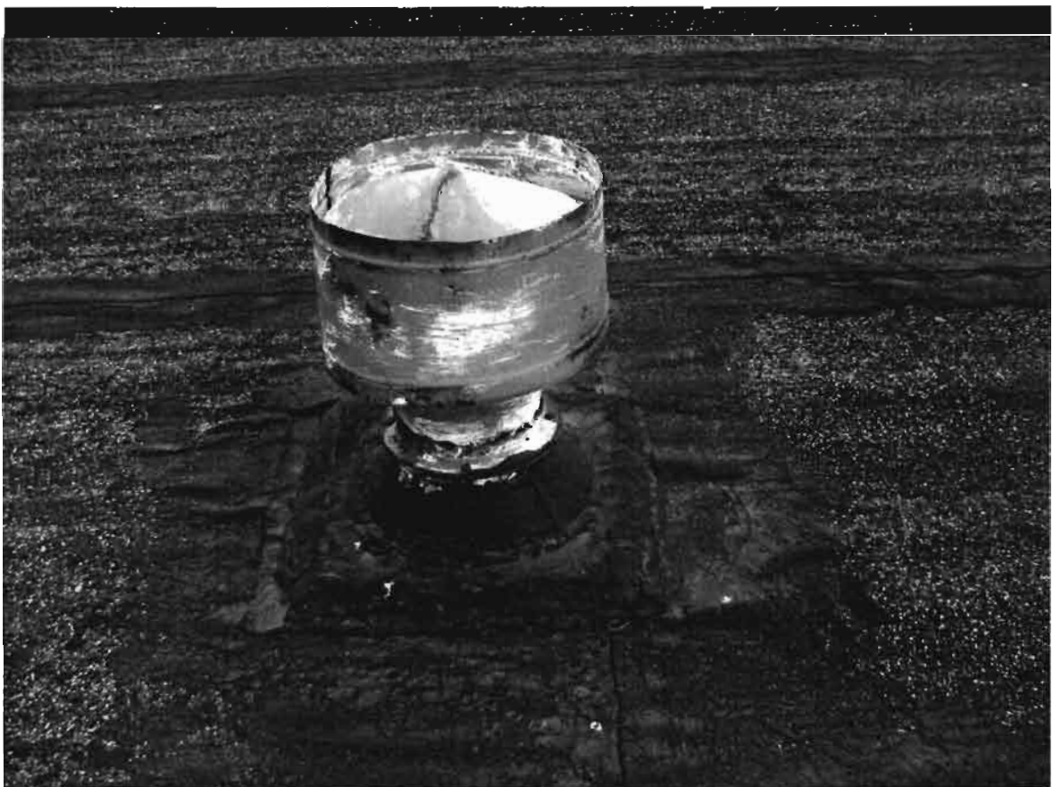
Zdjęcie Z-10 i Z-11 . Osadzenia wywietrzaków dachowych i wentylatora. Nieszczelna Izolacja wokół podstawy dachowej, powoduje przeciekanie wody opadowej do wnętrza pomieszczeń.
