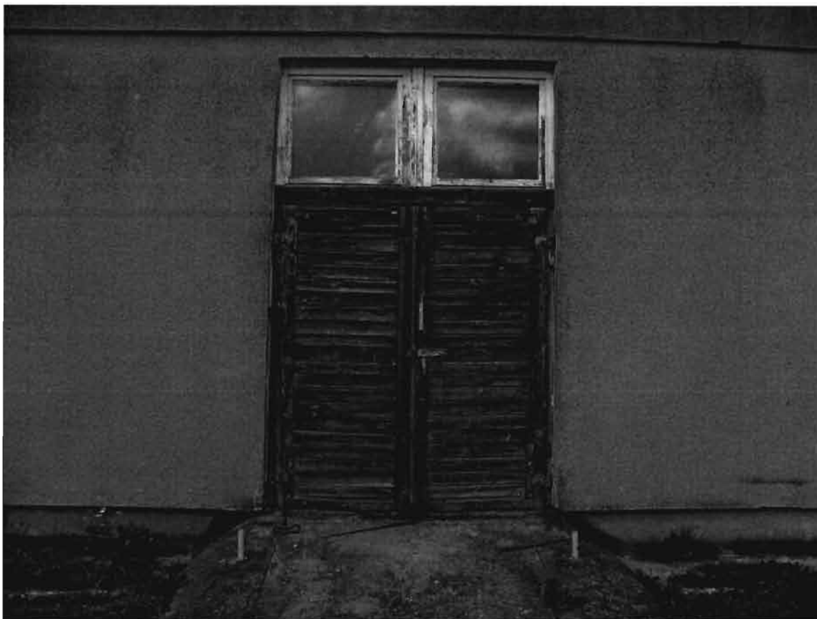
Zdjęcia Z-12 . Wrota do hali technologicznej-spągowe, do wymiany.
