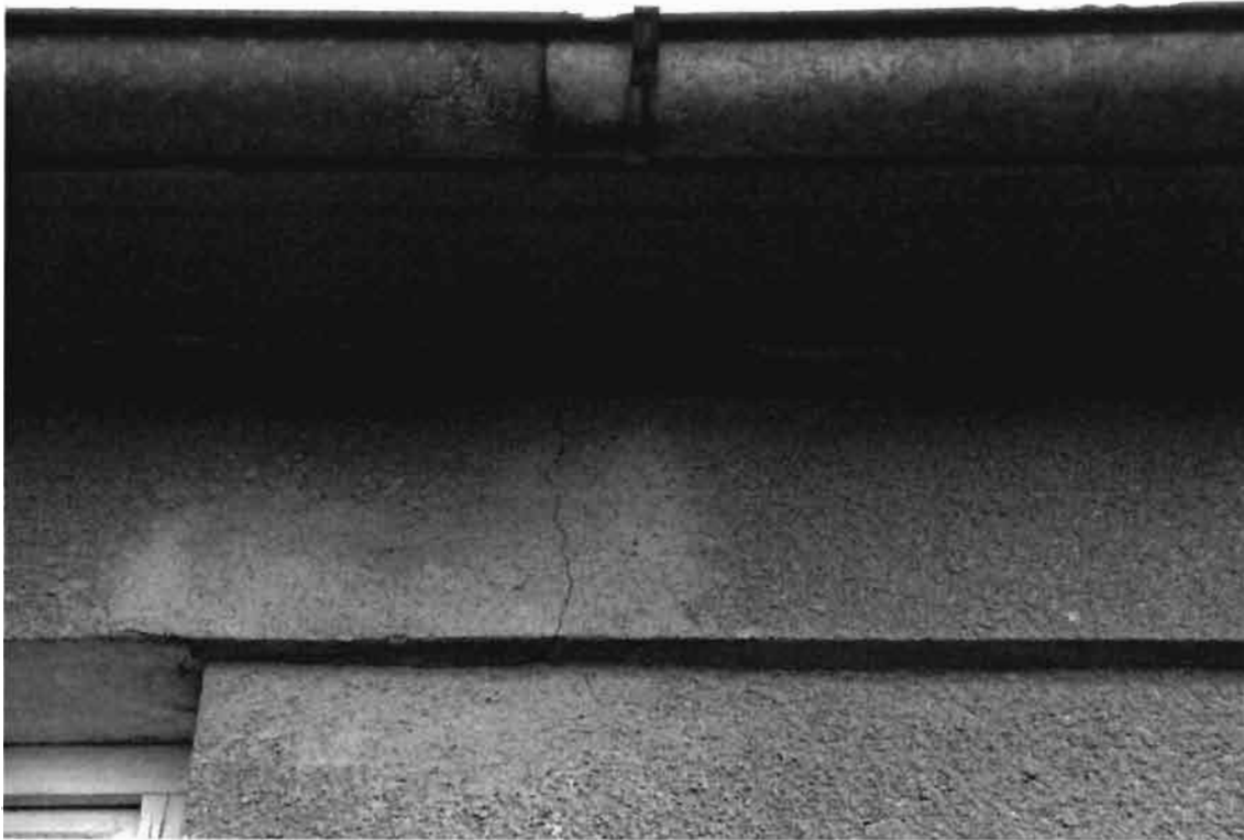
Zdjęcie Z-5. Rysy i pęknięcia w poziomie stropu kanałowego.
