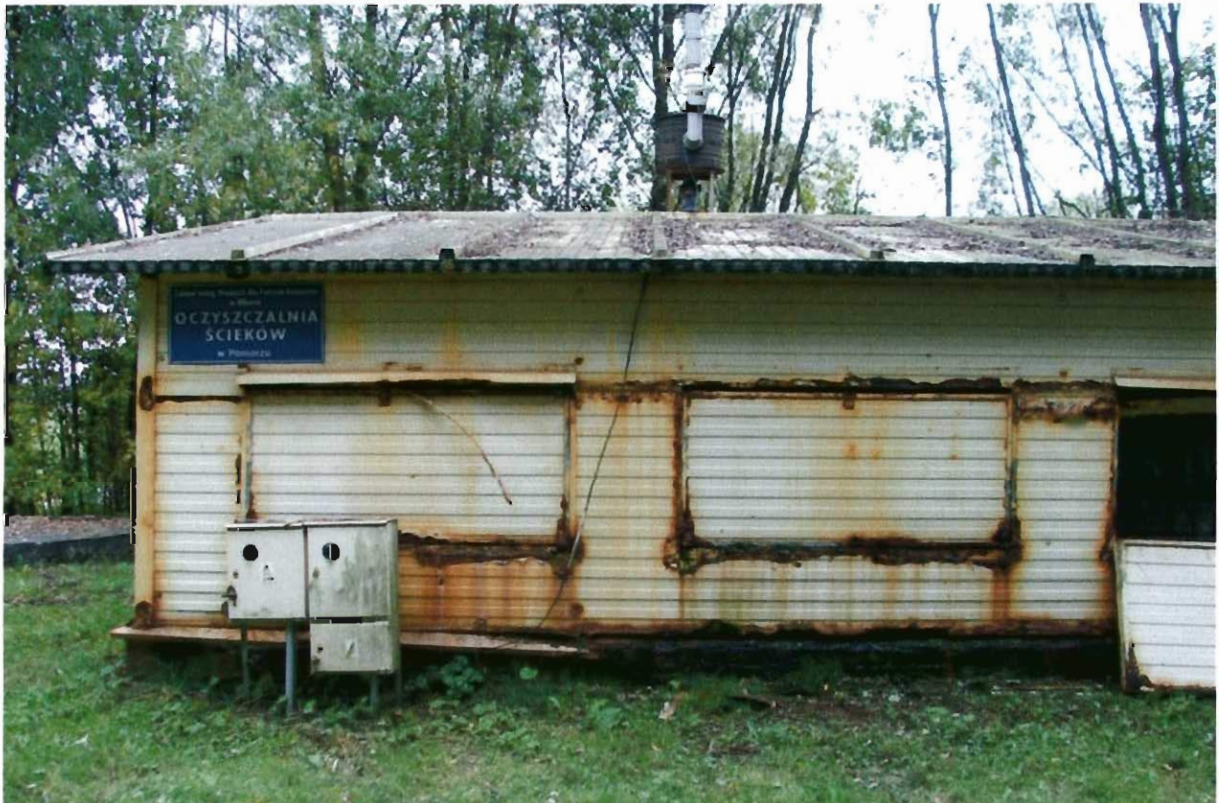
Z-2. Ściana podłużna. Zardzewiałe klapy montażowe. Zniszczony fundament
