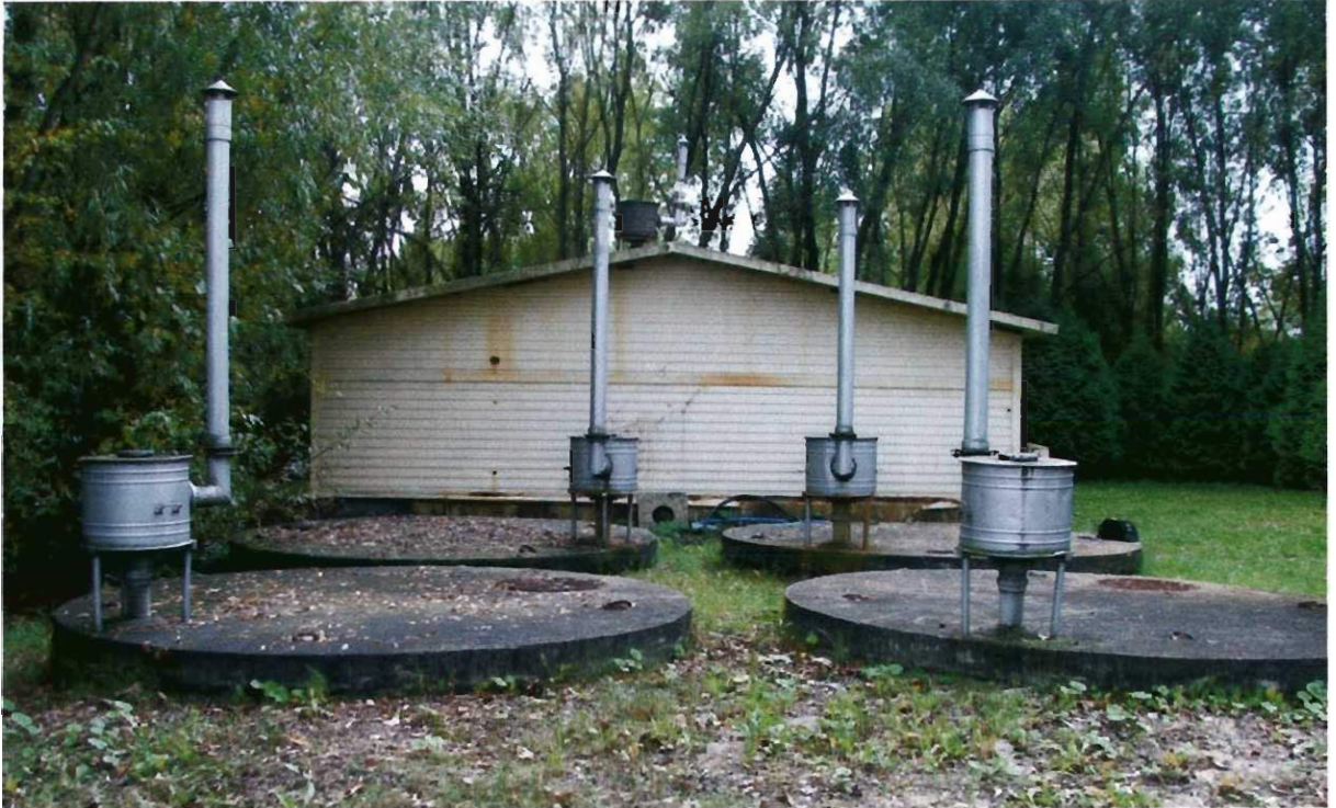
Z-1 Widok ogólny oczyszczalni ścieków w m. Pomorze. Pierwszy plan zbiorniki osadowe
