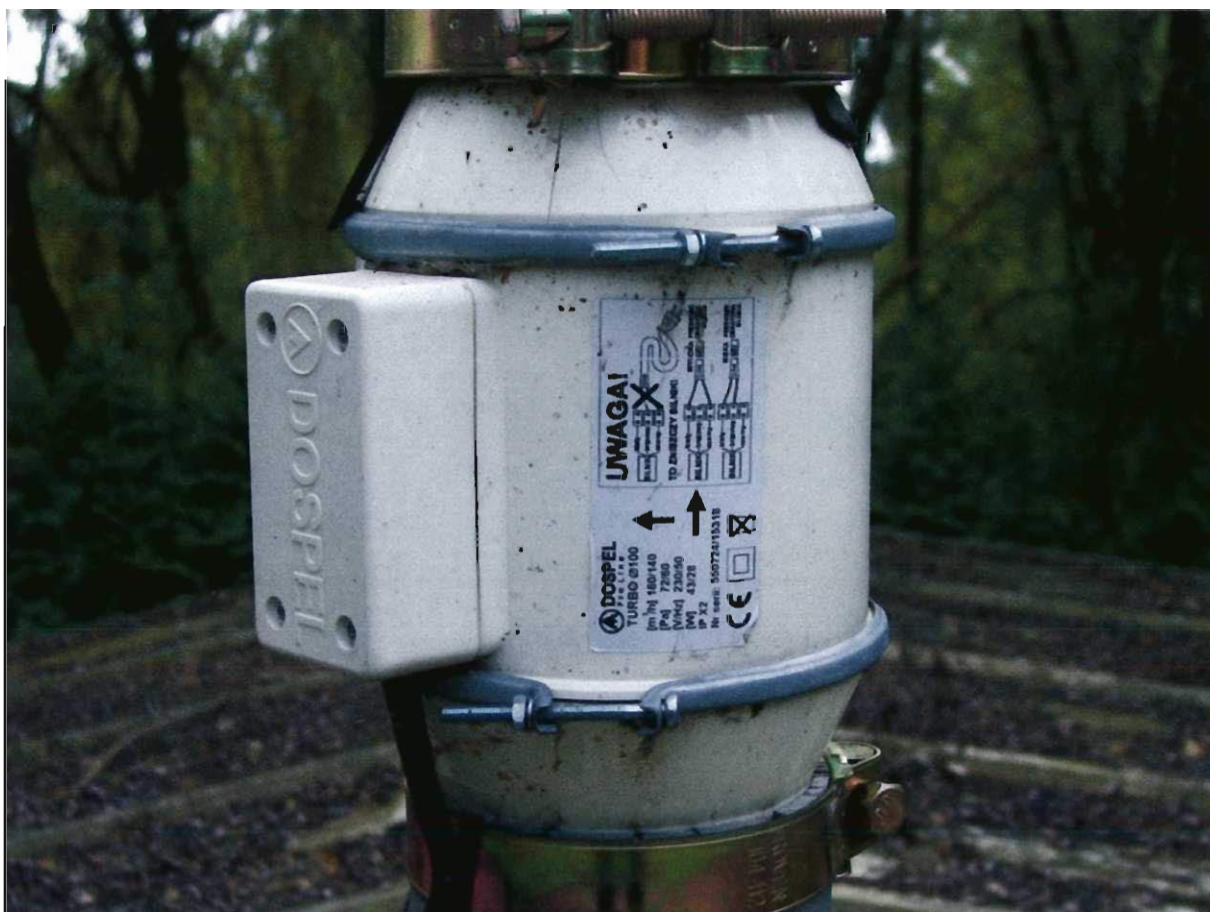
Z-5. Wentylator mechanicznej wentylacji wyciągowej na dachu budynku.
