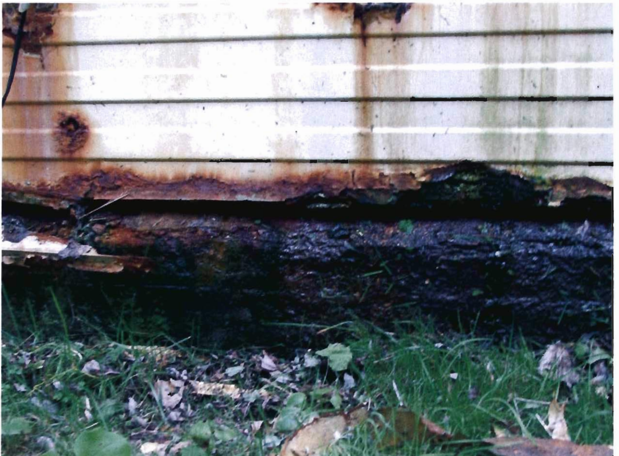
Z-4. Zniszczony fundament. Ścieki przenikające z wnętrza po ścianach osłonowych.
