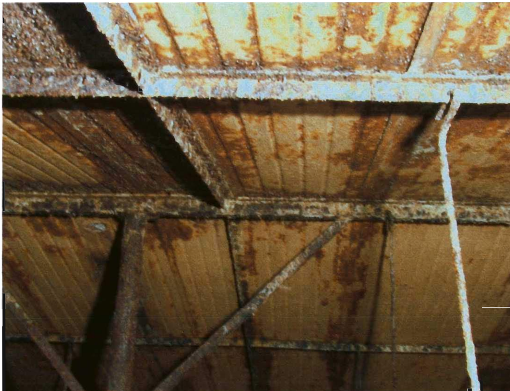
Z-9. Zniszczona konstrukcja dachu i podciąg NP 100
