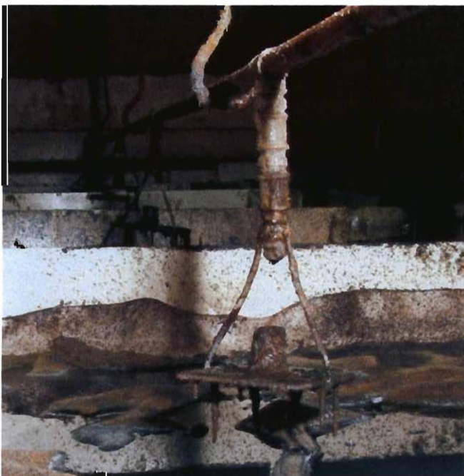
Z-8. Skorodowane urządzenie rozbryzgowie.
