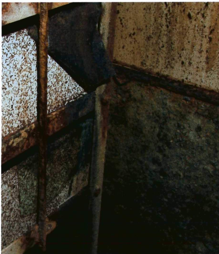
Z-10. Ściana fundamentowa, widoczne ubytki betonu.
