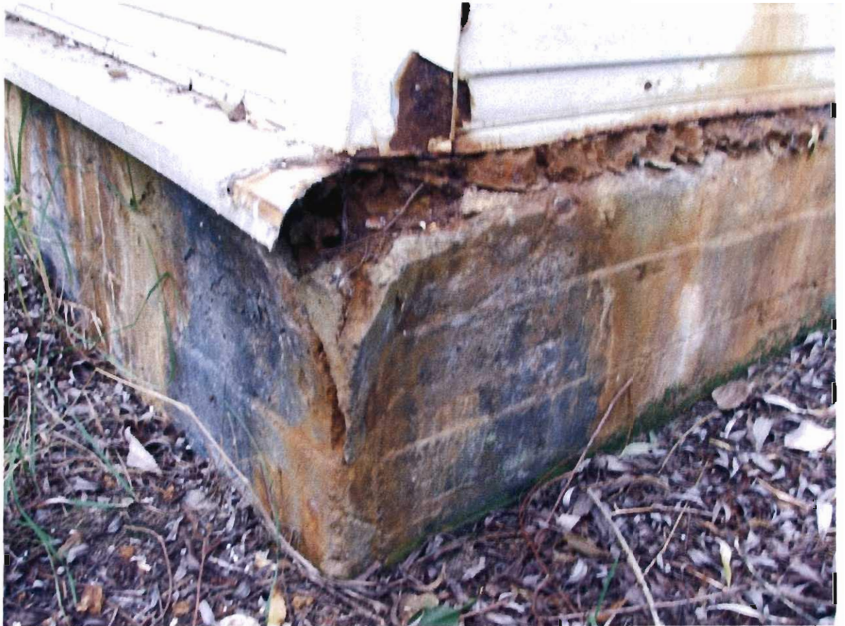
Z-3. Pęknięty narożnik fundamentu. Brak blachy osłaniającej cokół.
