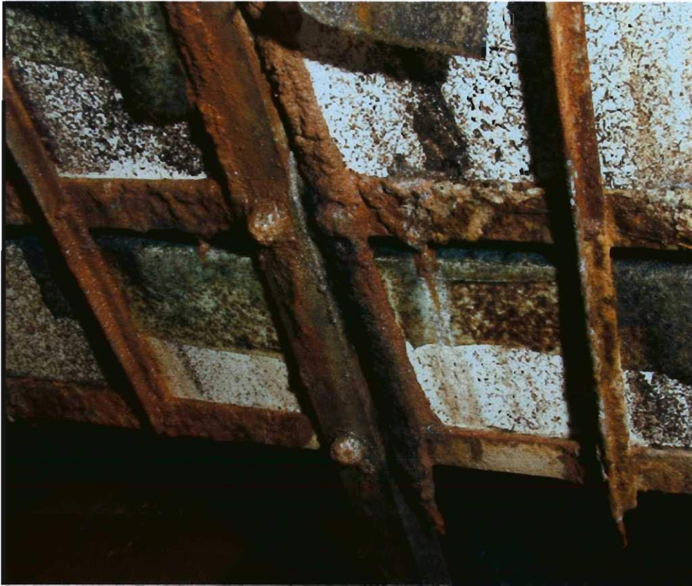
Z-11. Zardzewiałe elementy konstrukcji złoża torfowego. Słup S-2 i burtowy
